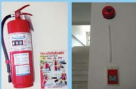
ถังดับเพลิงและระบบฉีดน้ำในหอพัก
